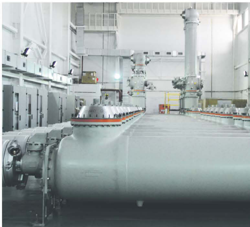
Помещение КРУЭ 500 кВ Воткинской ГЭС
