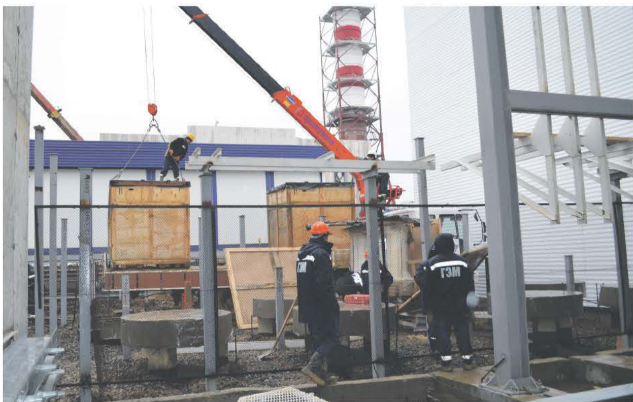
На объектах первого пускового комплекса БоАЗа приходится работать в максимально сжатые сроки. Необходимо запустить ГПП, чтобы подать электроэнергию на завод.
