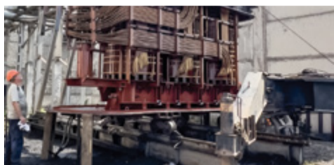
Специалисты БМУ ГЭМ выполнили капитальный ремонт трансформатора на Братском заводе ферросплавов → стр. 4
