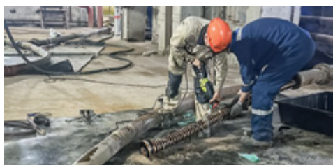
АО «ГЭМ» выполняет работы по расширению схемы выдачи мощности Амурской ТЭЦ-1 → стр. 1
